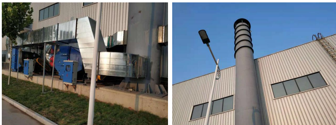
图 4-4 加弹二车间废气处理措施
